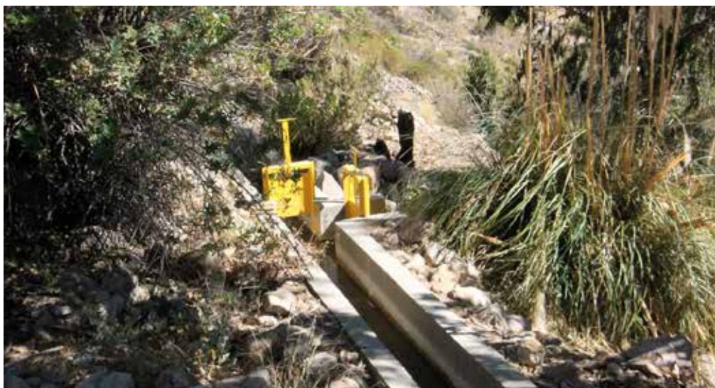
Imagen 55 Un tramo del canal del pueblo, actualmente de loseta de hormigón y con compuertas metálicas para el desvío del curso de agua hacia cada “entrada predial”, en las parcelas.
